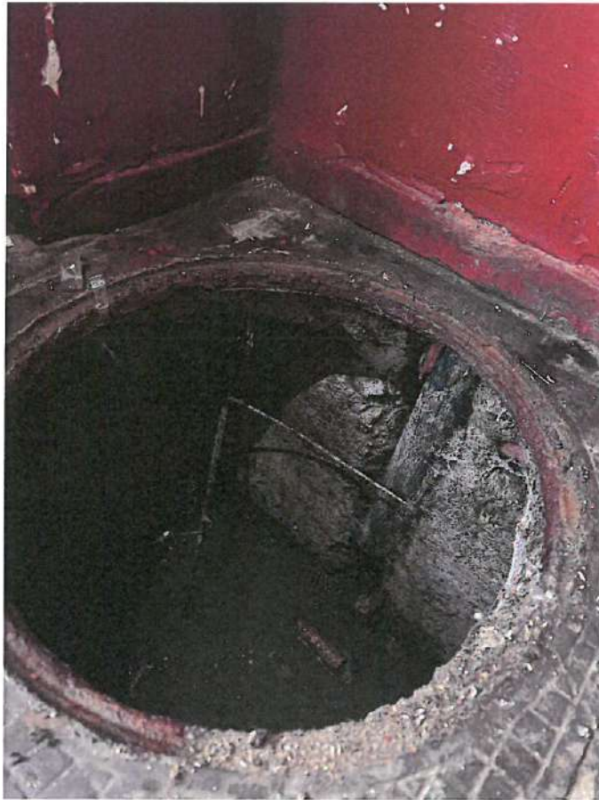
SUBSOL TEHNIC INUNDAT
