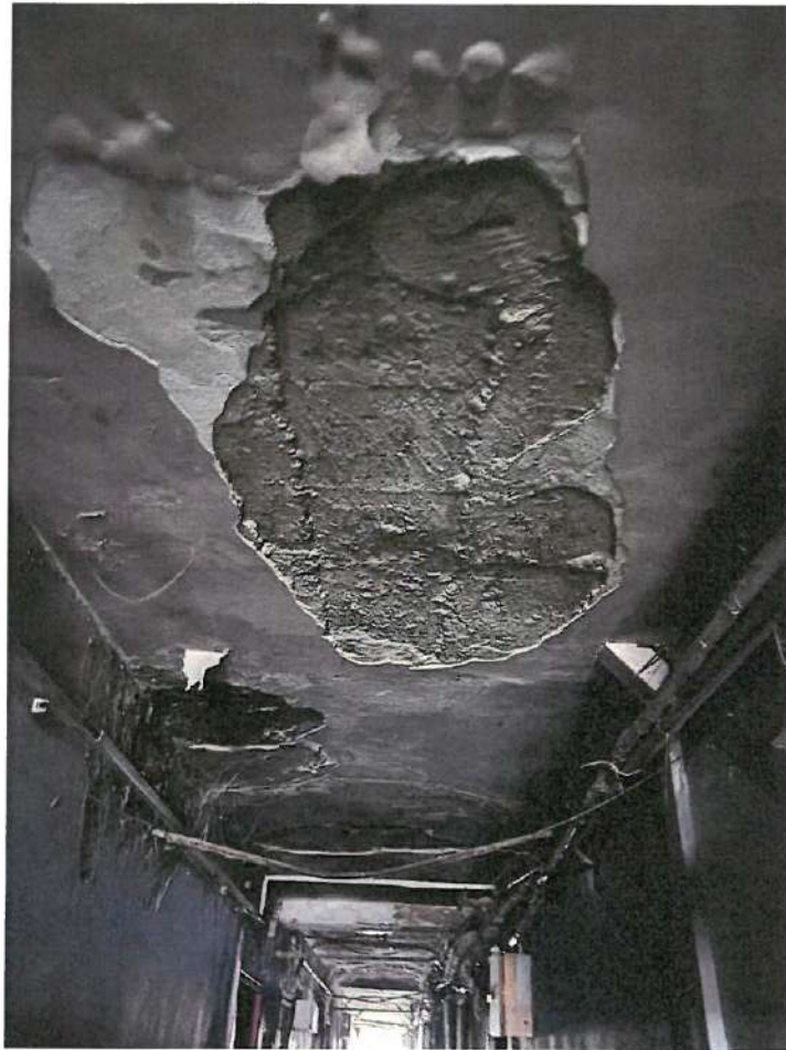
TAVAN DEGRADAT FIG. 7
